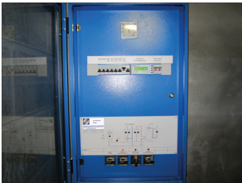
Sopra: quadro comandi – centrale termica
