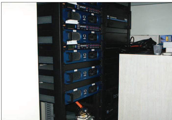
Foto della sala server dall'esterno (ricerca guasti)
