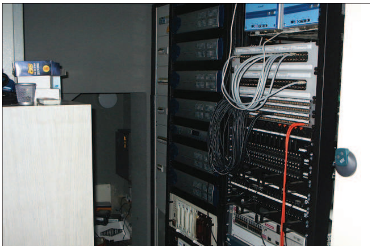
Foto della sala server.
