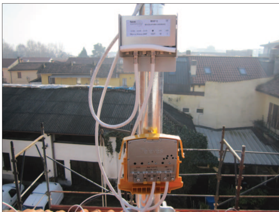
Sotto: dettaglio centralino terrestre da palo
